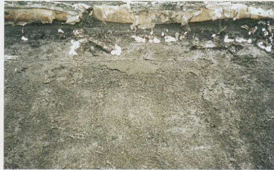
Bij de opstanden zijn de aluminium profielen gesmolten.
